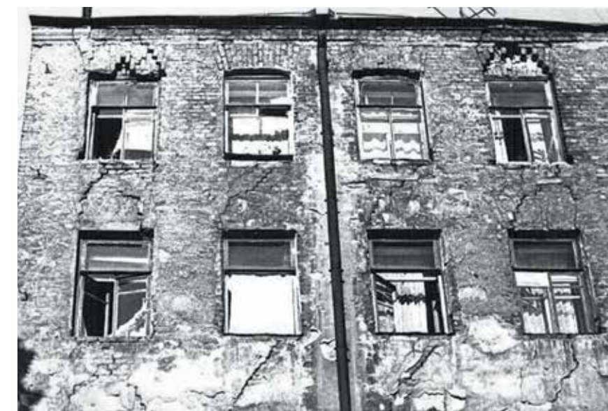
Флигель дома 24 со стороны ул. Писарева, где жила Н. Г. Тенигина. 1941 г. Трещины в кирпичной кладке под каждым окном
